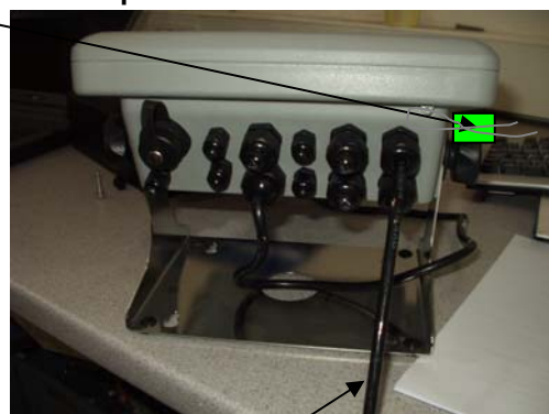
Spoj kablova MPS u kućištu EPU
